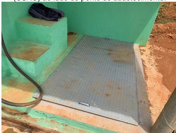
Figura 05: Caixa separadora de água e óleo (CSAO) ao lado do ponto de abastecimento.
