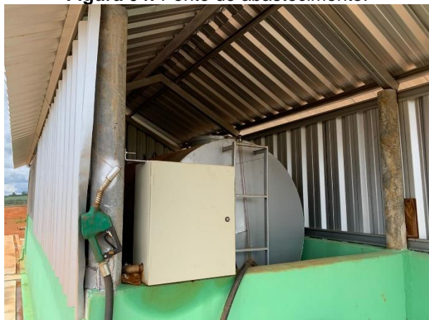
Figura 04: Ponto de abastecimento.
